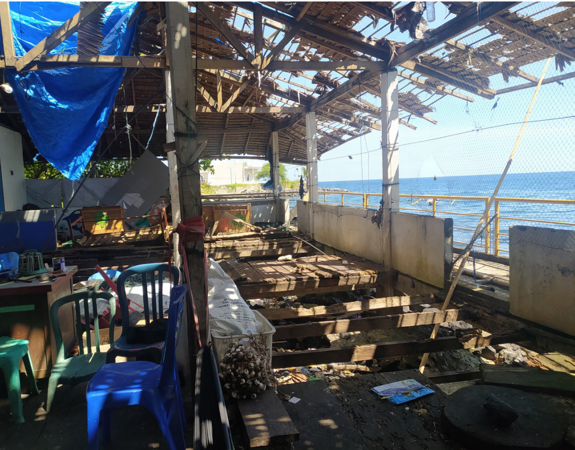
Gambar 2.22: Gelombang tinggi menyebabkan kerusakan Daseng di Sario.
